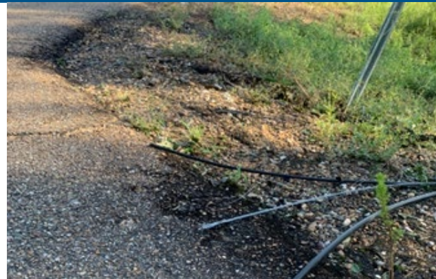
No corte cables. Es más rápido reparar que reemplazar cables dañados.
