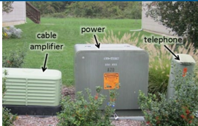
No acumule escombros cerca o sobre tableros de servicios públicos.
